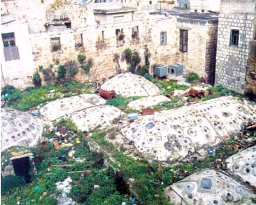
شكل رقم (9): منظر خارجي لسقف حمام الجديدة وتظهر فيه الثقوب المغطاه بالزجاج
